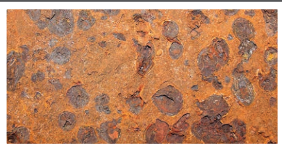
Corrosione localizzata e corrosione diffusa
